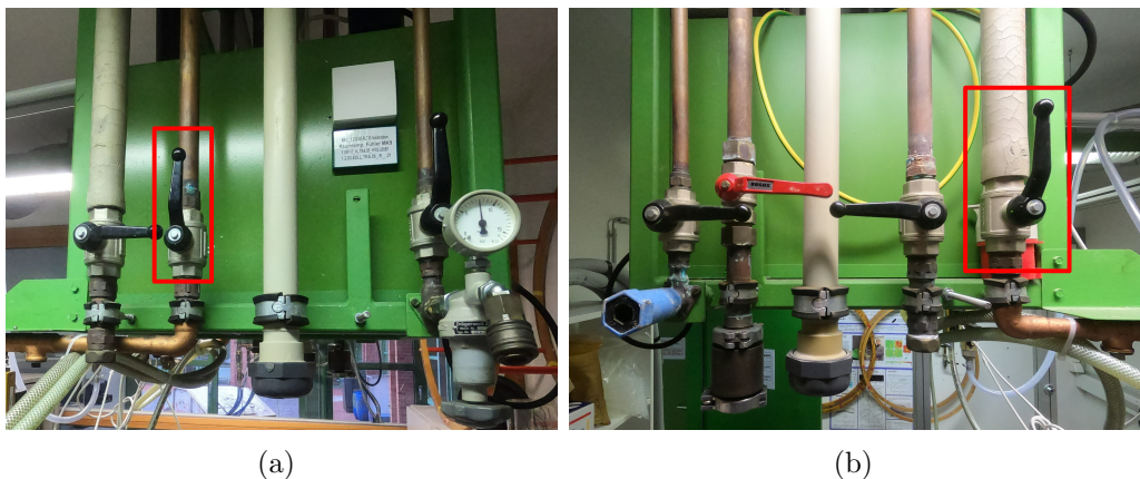
Abbildung 17: Die zwei Hauptwasserhähne für Zu- und Abwasser der Wasserkühlung. Sie sind rot umrahmt und befinden sich im geöffneten Zustand. Zum Schließen muss der jeweilige Hebel in waagerechte Position gebracht werden. Abbildung (a) zeigt einen Teil der Leitungen im Raum und (b) den anderen, der rückseitig dazu gelegen ist.
